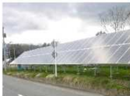
柵塀の設置されない設備
