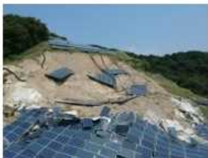
土砂崩れで生じた崩落
